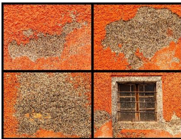
W. Linker Fensterbruch
